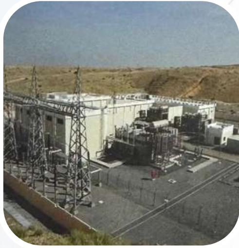
الشركة العمانية لنقل الكهرباء
